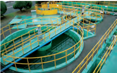
창원공장 폐수처리 시설
