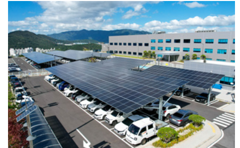
울산 전동화 공장 주차장에 설치된 태양광 발전 설비
